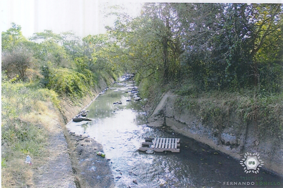
Figura – Rede pluvial que vem do bairro Jardim Yara e lança esgoto indevido no Rio Mandú (ponto 2 no mapa)
